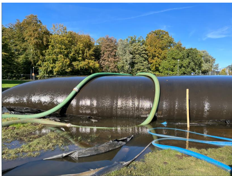
Figur 5: Figuren viser en opstillet Geotube ved et projekt i Hillerød. Sedimentet tilbageholdes i Geotuben, imens det afvandes.
