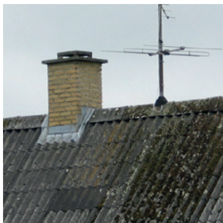
Ældre eternittage indeholder som oftest asbest.
