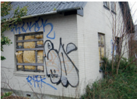
Konddemneret hus malet med blyholdig murlæmning. Før nedrivning skal malingen renses af og opsamles for korrekt bortskaffelse.
