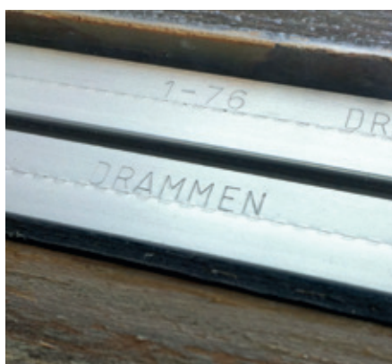
Prægningen i rudens afstandsliste viser, at ruden er fremstillet i januar 1976 (1-76). Ruden kan derfor indeholde PCB.
