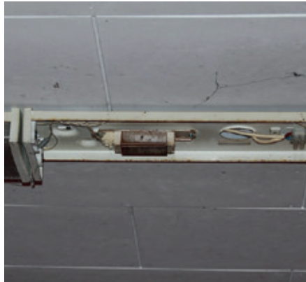
Ældre armaturer til lysstofrør indeholder ofte PCB.
